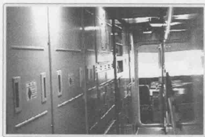
(a) HXD 3 型电力机车变流柜
