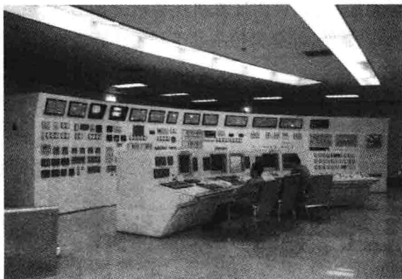
图 0-3 某热电厂计算机控制系统控制室
