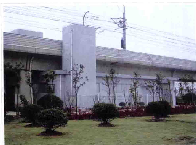
区间牵引变电所
