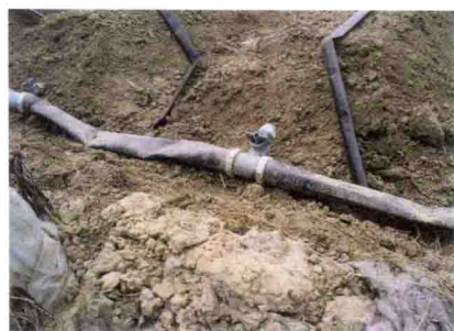
彩图 21 供水塑料管道
