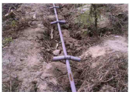
彩图 22 供水塑料支毛管道
