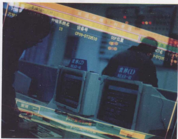
网管监控——确保安全畅通
