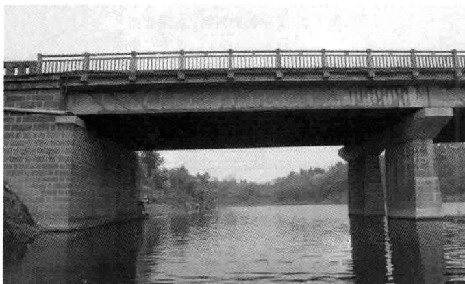
图 1.1 T 梁桥的病害
