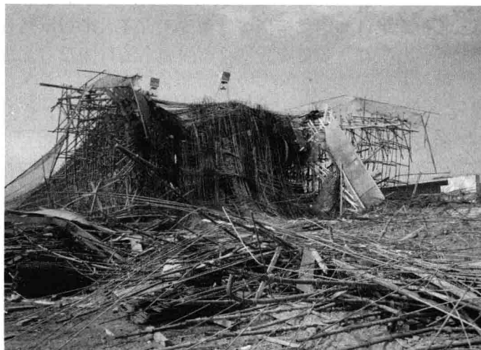
图 2-4 云南省昆明新机场“1·3”支架坍塌事故现场(一)
