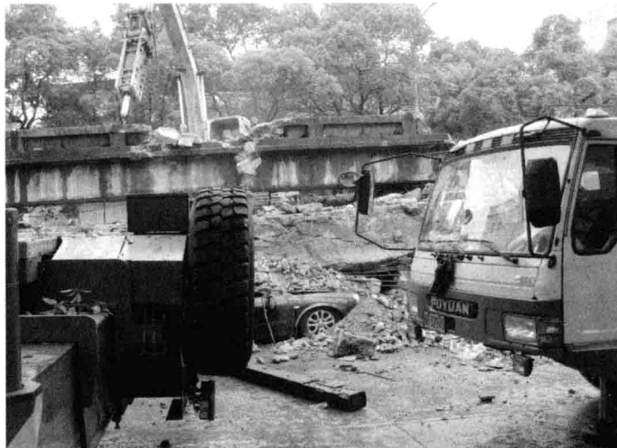
图 2-2 湖南省株洲市“5·17”桥梁拆除工程坍塌事故现场（二）
