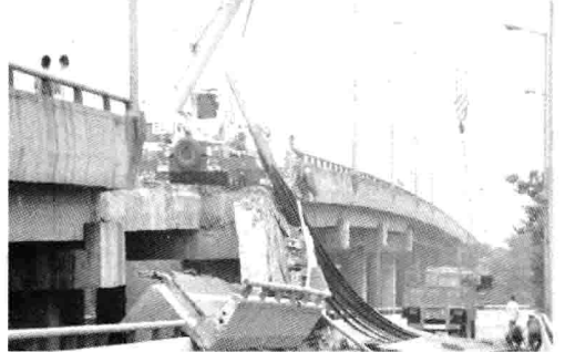
h) 钱塘江大桥桥面出现塌落
