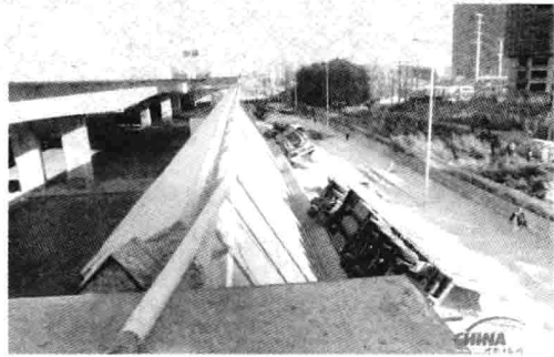
j) 哈尔滨阳明滩大桥断裂
