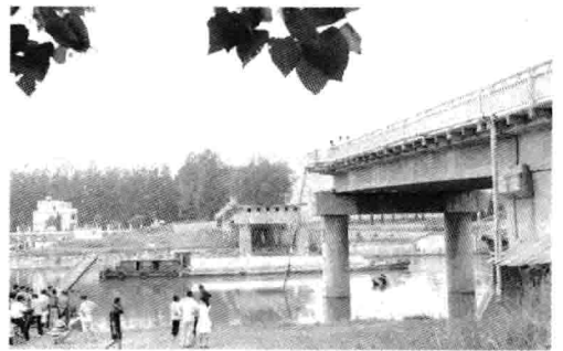
f) 榆河桥发生坍塌
