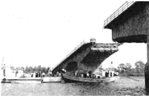
图 1-2 超限超载运输引起的桥梁垮塌事故
