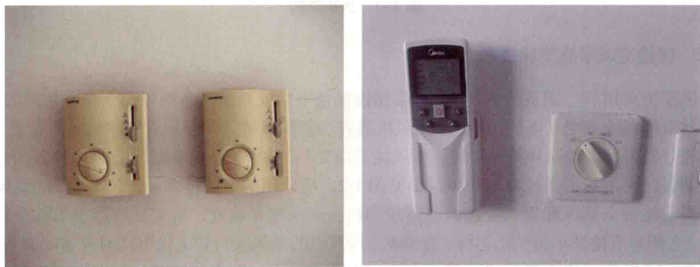
图 1-3 空调系统控制装置
