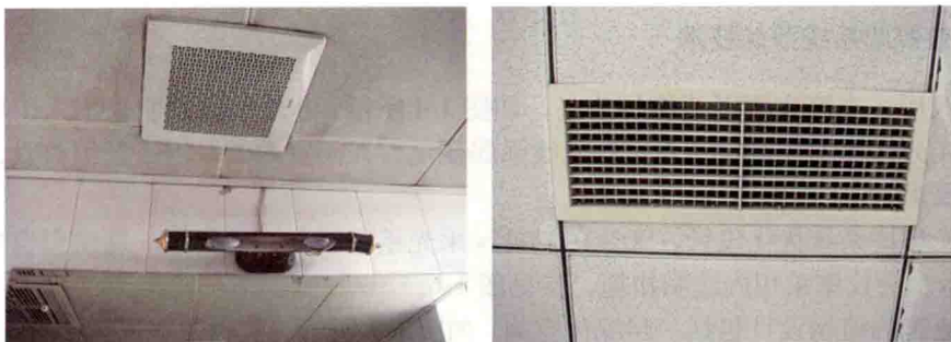
图 1-2 空调送风口及回风口(一)
