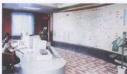
2007年，荆门市供水总公司生产调度系统
