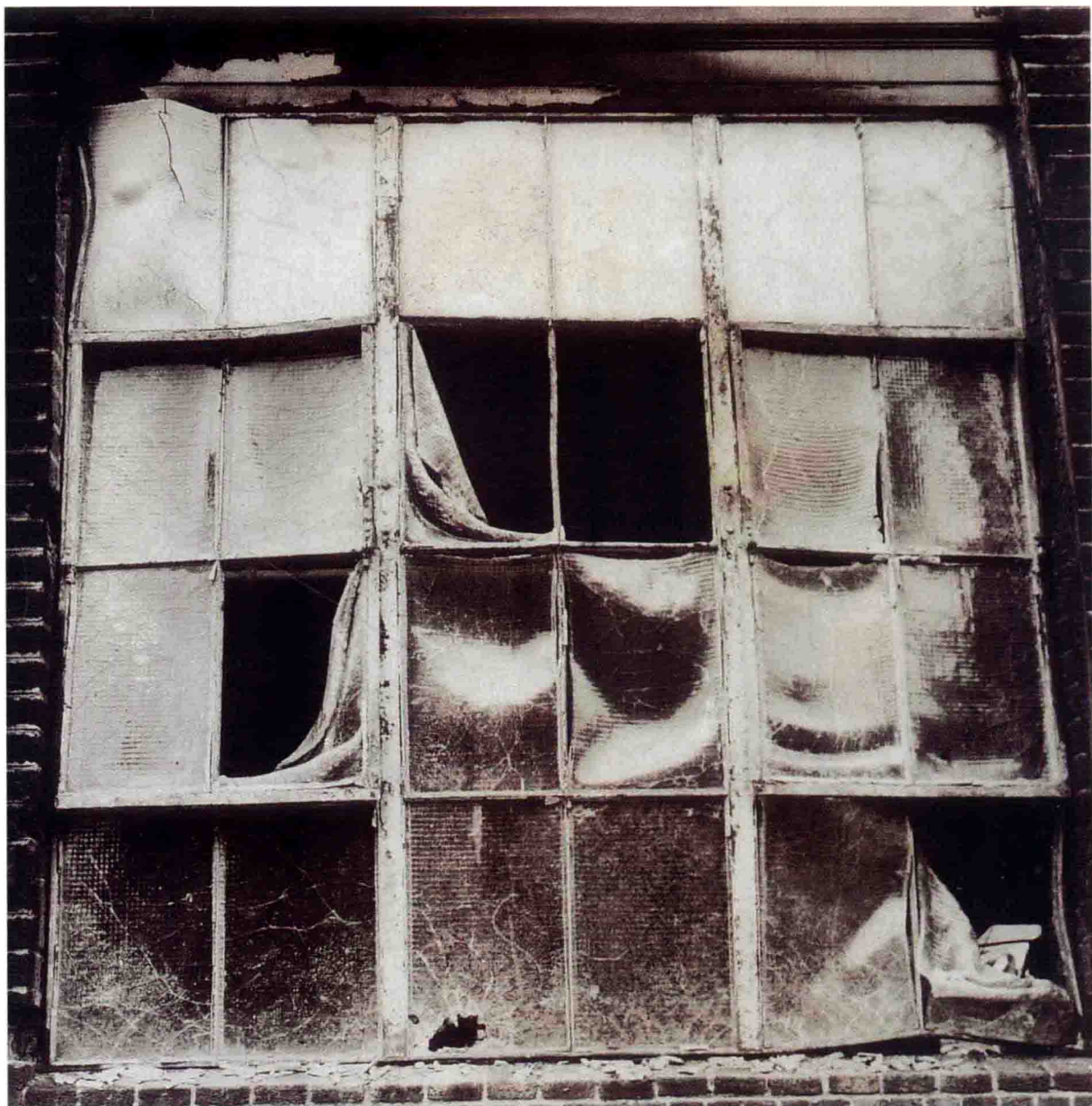
图11 火灾后的由金属丝加固的窗玻璃，在室温时玻璃冻结为固体，重新加热后扭曲。嵌入玻璃中的金属丝阻止了由于热量引起的玻璃的融化。
