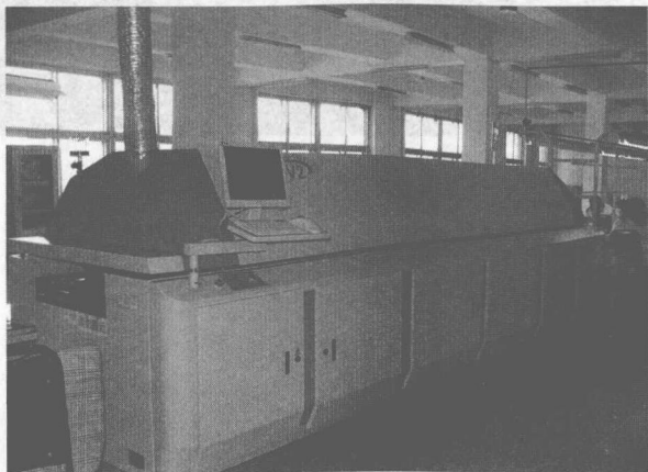
图 1-4 某电子产品生产企业的自动化焊接生产线
