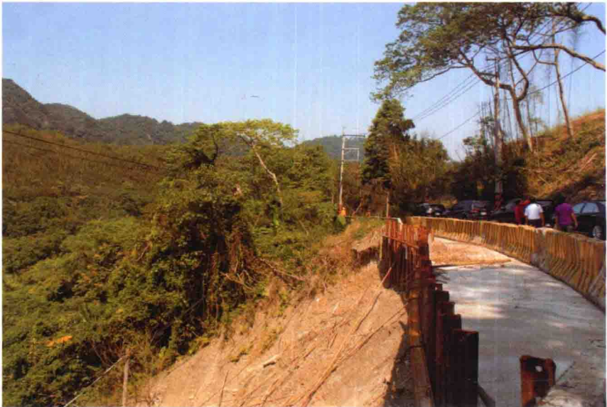
圖5-7 道路下邊坡崩落
