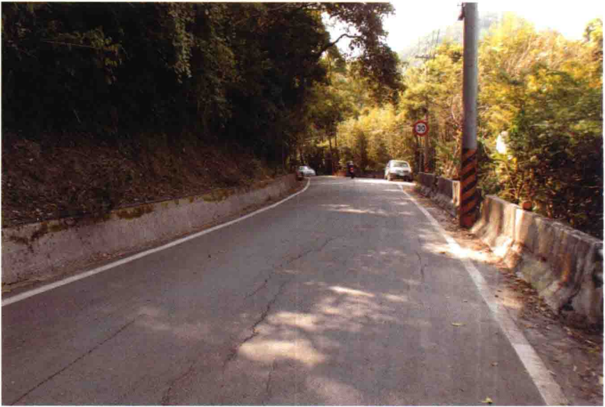
圖5-6 道路路面龜裂
