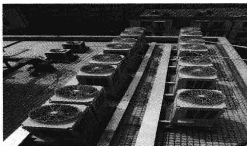
(a) 空调 VRV 室外机屋顶布置
