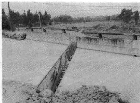
图 1-2 汶川地震某桥伸缩缝处震害
