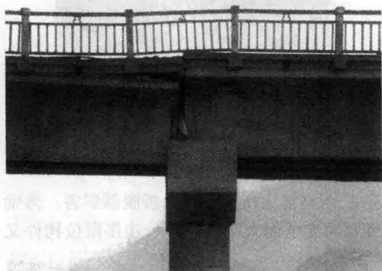
图 1-4 寿江大桥上部结构的纵向移位
