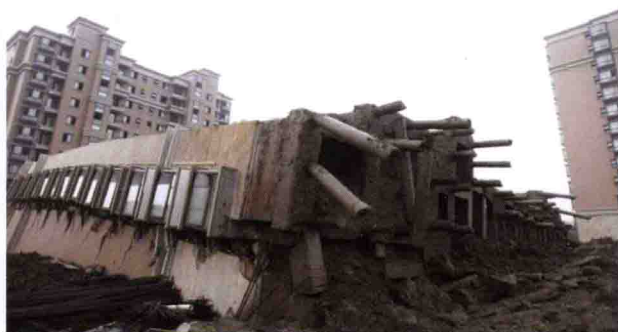
2009 年 6 月,上海市“莲花河畔景苑”7 号楼北侧在短期内堆土过高,同时紧邻大楼南侧的地下车库基坑又正在开施工,形成大楼两侧的压力差过大,致使土体发生水平位移。过大的水平力超过桩基的抗侧能力导致房屋整体倾倒。
