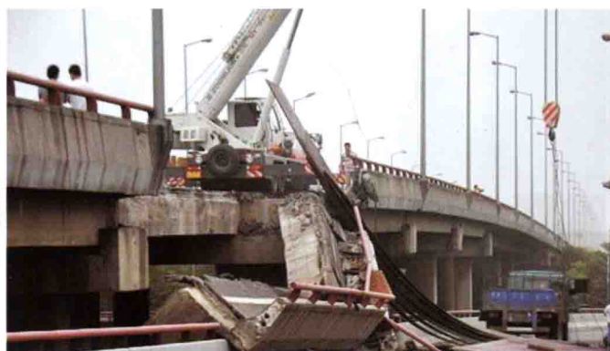
2011 年 7 月,杭州钱江三桥辅桥主桥面右侧车道部分桥面突然塌落,一辆重型半挂车从桥面坠落,又将下闸道砸塌。
