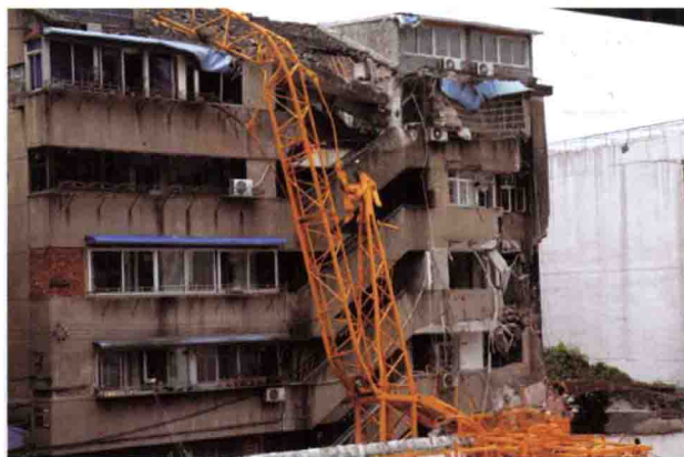
2011 年 11 月,温州市鹿城区双井头新村正在施工的高达 30 米的吊塔突然拦腰截断,砸中了该村 35、36 两栋居民楼。
