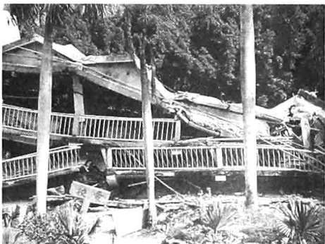
图 1.3 1999 年台湾大地震中倒塌的教学楼 [2]
