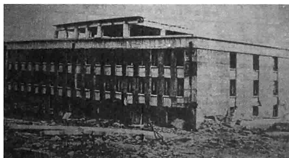
图 1.5 唐山地震中某房屋一层柱全部倒塌，上部坐落 [2]
