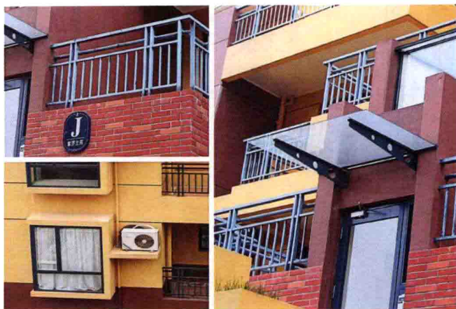
▲ 图1-1 交付使用仅两个月的建筑立面就面目全非，栏杆、雨篷锈迹斑斑
