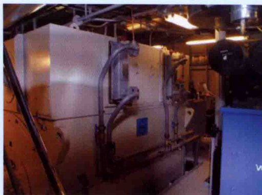
Arppe的变频器室与外部冷却风机
