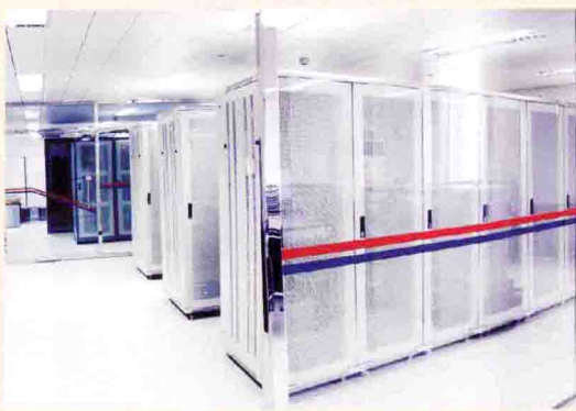
▲ 图为区信息中心机房
