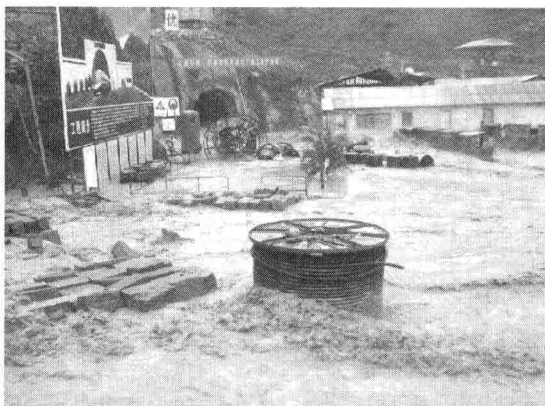
图 1-1 宜万铁路马鹿箐隧道出口段突水突泥现场
