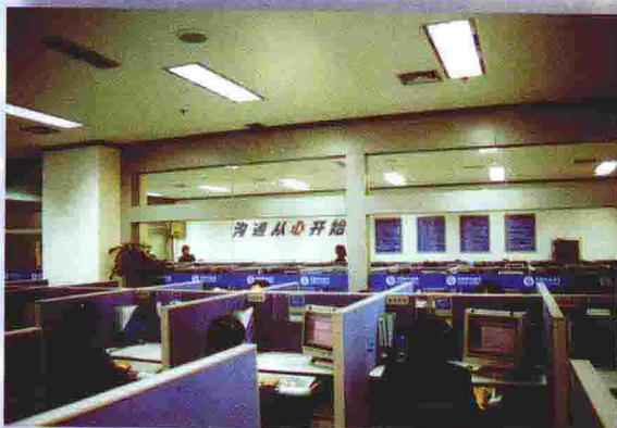
话务中心机房
