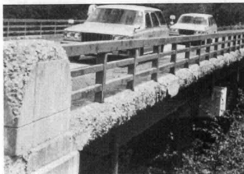
(b) 遭受冻融破坏的桥梁
