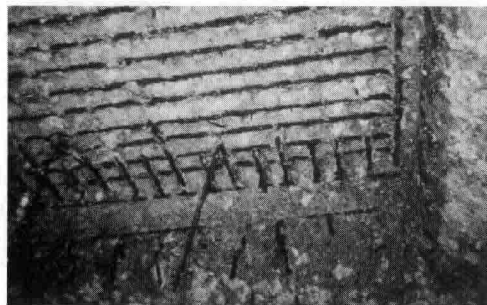
(a) 污水对混凝土结构的影响
