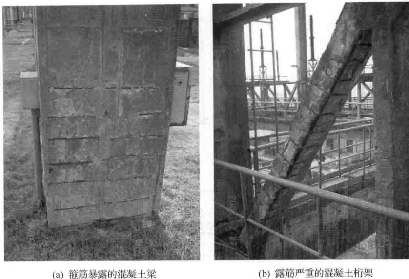
图 1-3 盐雾侵蚀环境下混凝土结构物的耐久性问题
