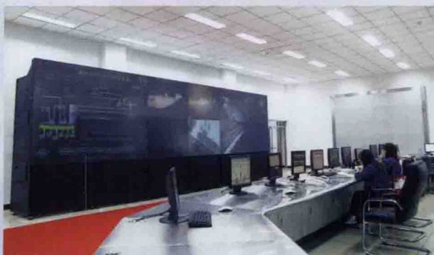
360m 2 烧结机主控室
