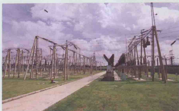
新建的220千伏陆良变电站一角
