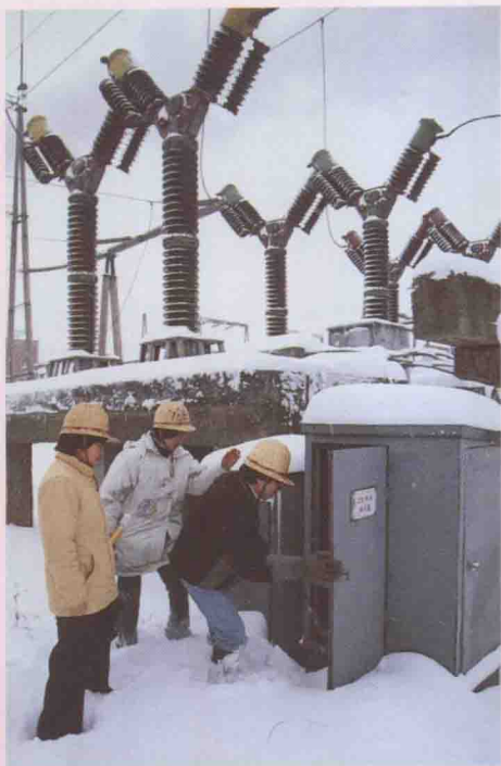
一场40年来未遇的大雪降临宣威 宣威发电厂运行人员精心检查设备确保 安全稳定发电
