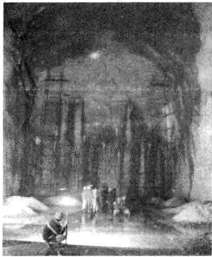
图 0-2 岩壁岩石裂隙水流水照片
