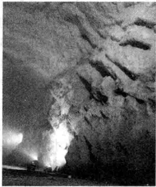
图 0-3 毛洞侧壁凹凸不规则情况照片
