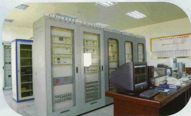
室内“四遥”无人值守 110千伏美华变电站
