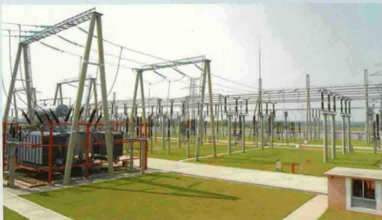
2002年8月8日，220千伏 圣堂变电站建成投产，成为 粤西、粤中220千伏枢纽站
