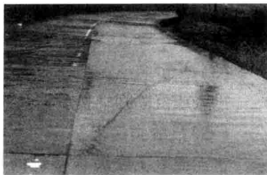
图 2-1 路基沉降引起的斜向裂缝
