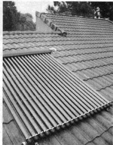
图 1-13 一个带真空管集热器的太阳能热水系统（来源：Global Sustainable Energy Solutions）
