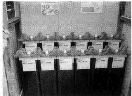
图 1-6 独立太阳能发电系统中的蓄电池组（来源：Global Sustainable Energy Solutions）
