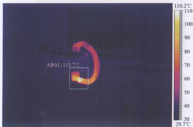
图 1-10 110kV 主变压器本体螺栓短接线发热
