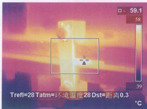
图 1-8 220kV 主变压器大盖与底座连接片温度异常
