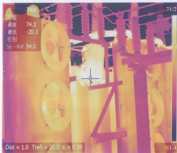
图 1-4 330kV 主变压器升高座局部发热
