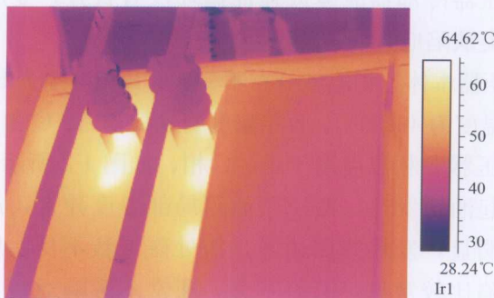
图 1-3 500kV 主变压器油箱局部温度过高
