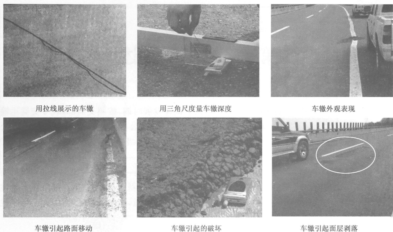
图 1-1 沥青路面车辙变形及面层破坏实例
