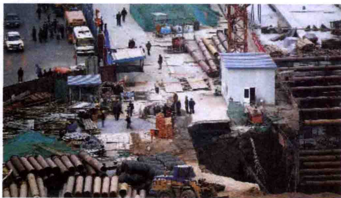
图 1.1.9 北京地铁 10 号线熊猫环岛基坑坍塌
