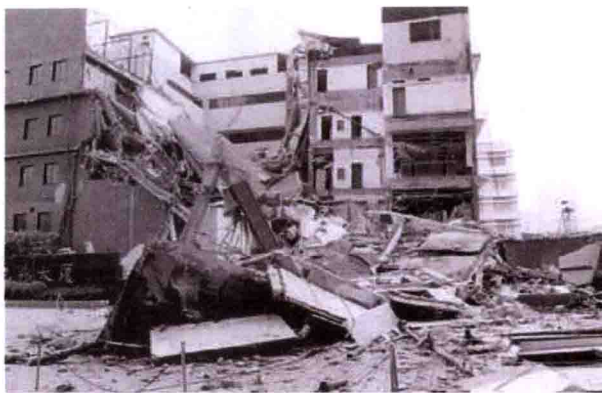
图 1.1.7 上海轨道交通 4 号线的施工事故
