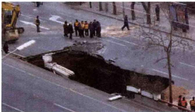
图 1.1.8 北京地铁 10 号线十四标段呼光区间塌陷
