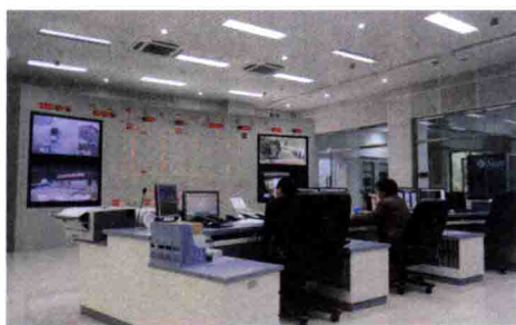
图 1-1 某水电站中央控制室
