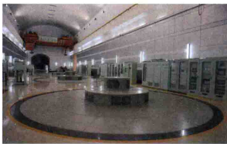
图 1-2 某水电站发电机地板层
