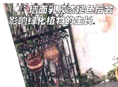
图1-27 墙面乳胶漆褪色
