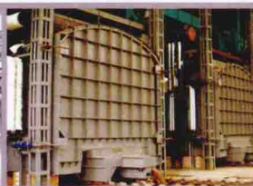
燃发生炉煤气退火炉群
