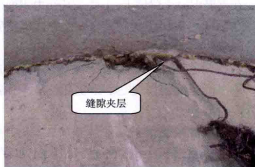
图 1-24 墩柱与盖梁交界处的混凝土缝隙夹层
