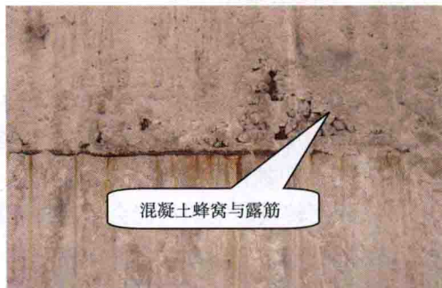
图 1-17 梁体混凝土蜂窝与露筋
