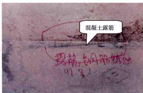
图 1-22 钢筋外露锈蚀
