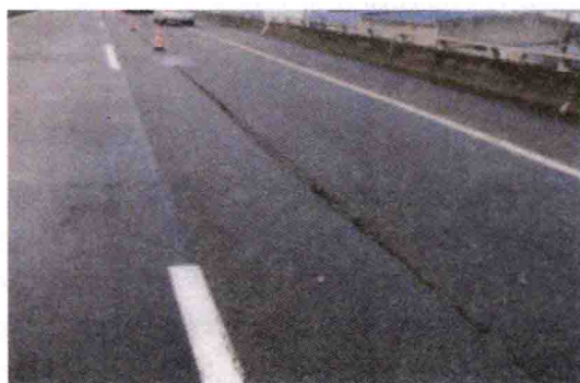
图1-26 铰缝破坏导致桥面铺装的纵缝与破坏
