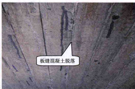
图1-27 板缝混凝土脱落
