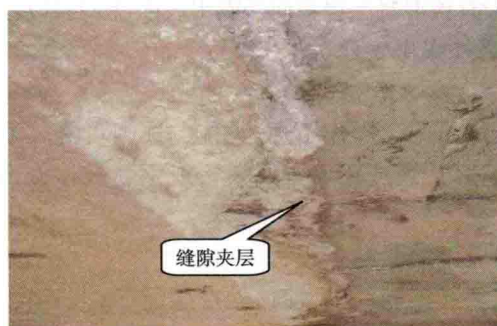
图 1-23 箱梁顶板缝隙夹层
