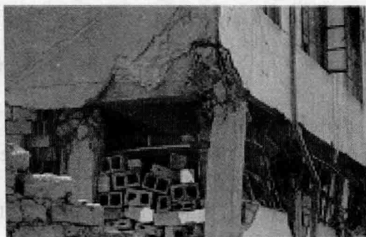
图 1.16 在玉树地震中某框架民房角 柱上端剪坏、混凝土压碎、纵筋压曲
