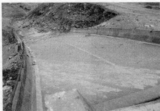
图 1.13 汶川地震时引发滑坡冲毁桥梁
