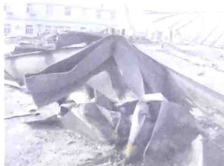
图 1-14 火灾中钢构件严重变形
