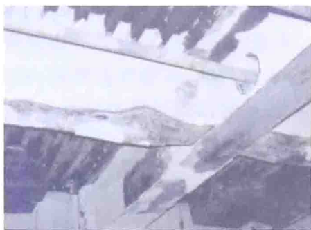
图 1-10 火灾引起梁局部屈曲
