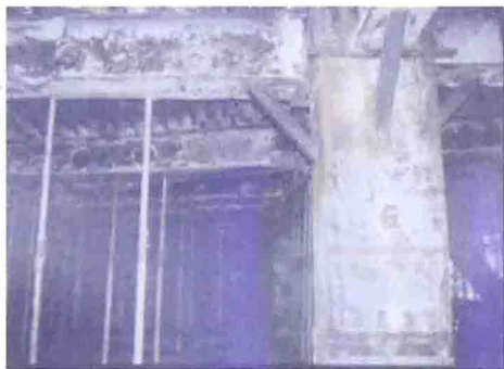
图 1-9 火灾引起柱连接断裂
