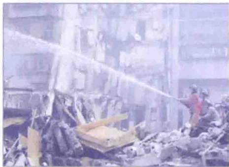
图 1-15 衡阳 8 层砖混结构建筑坍塌
