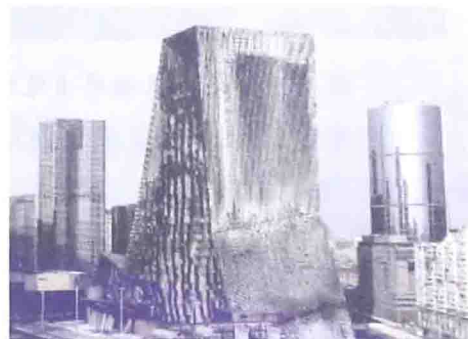
图 1-17 火灾引起外部钢网架严重受损
