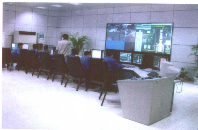
本钢二铁厂易地大修后的3号高炉中控室
