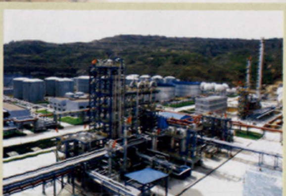
聚丙烯生产装置
