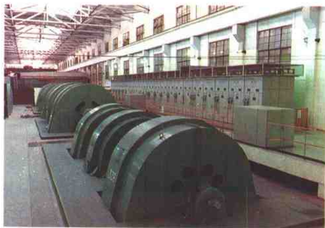
上海電機廠汽輪發電機試驗站(百萬 kW 級)
