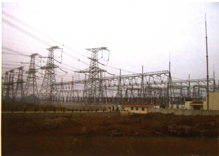
2001年11月25日开工， 2002年12月31日竣工的500千 伏安顺变电站是贵州电网的一 个大型枢纽变电站，是“西电东 送”的重要通道 (罗永忠 摄)
