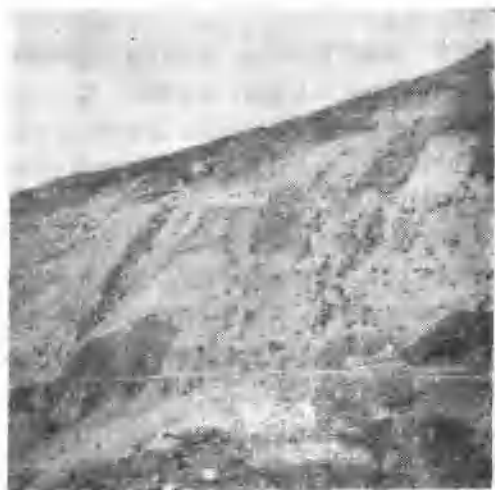
图1-1 回头路綫边坡坍塌情况
