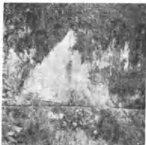
图1-2 崩塌软弱面（图中白色部分）
