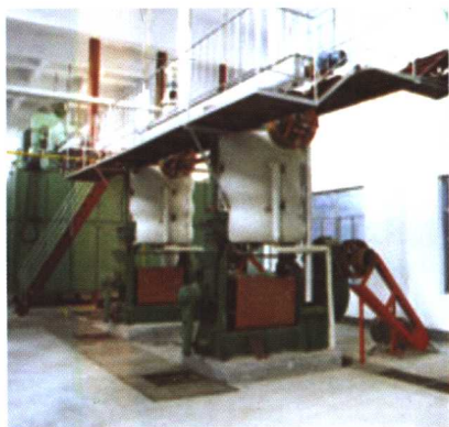
油料预处理车间设备
