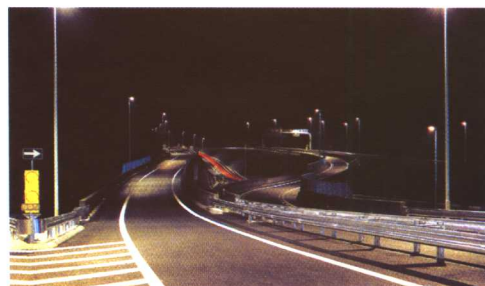
图 63 采用常规道路照明方式为立交提供照明
