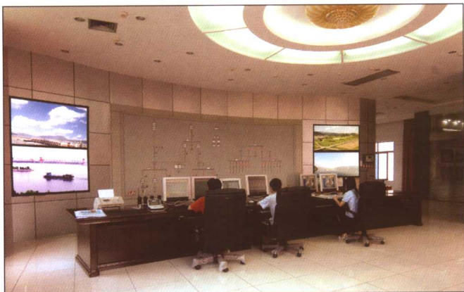
枢纽总控中心
