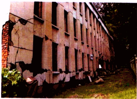
唐山市原河北省矿冶学院图书馆书库大楼一 楼全部被震陷地下
