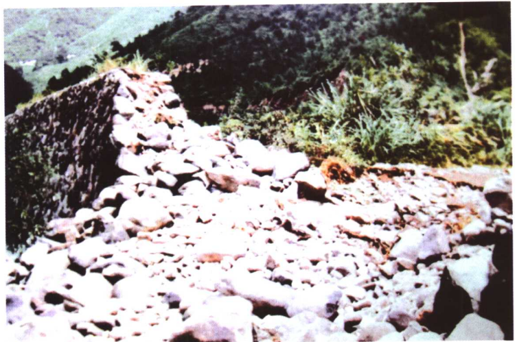
1989年7月22日，受8909台风影响，庆元县出现特大暴雨，洪水冲倒防洪堤
