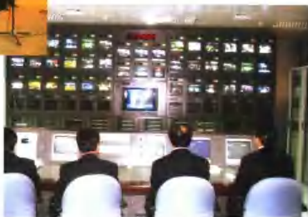
▲ 装备设施一流的有线电视传输中心播控机房。
