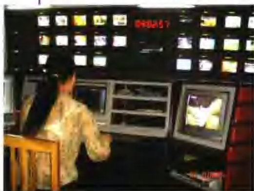
设备齐全的有线电视监控机房。
