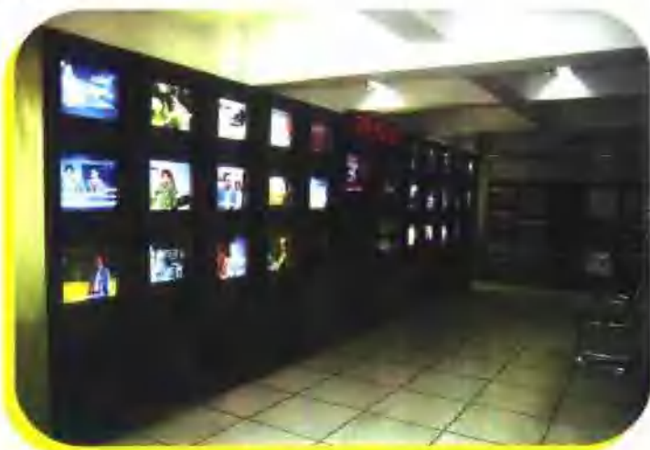
▲ 泊头市广播电视局电视播控机房。
