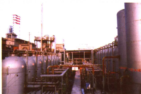
▲变压吸附生产装置
